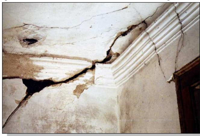
Figura 2 – Revestimento com fissuras de origem estrutural.
