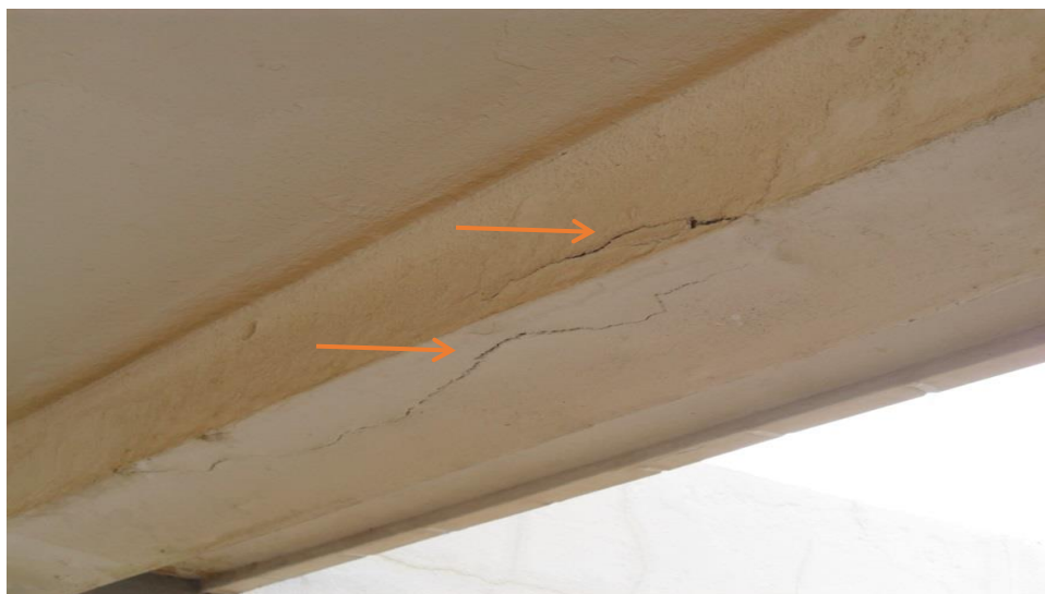
Figura 6 - Destacamento do revestimento da viga, localizada na portaria do condomínio.
