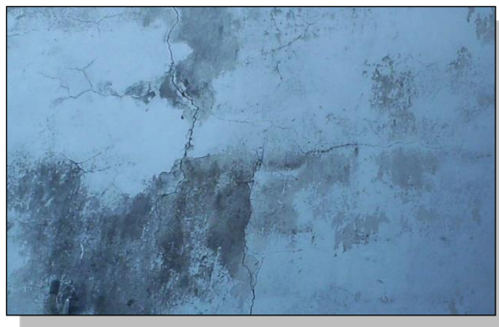
Figura 1 – Fissuras em revestimento de fachada.
