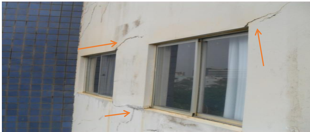
Figura 13 - Fissuras aparentes na parte superior das janelas, fachada principal do Edifício C.
