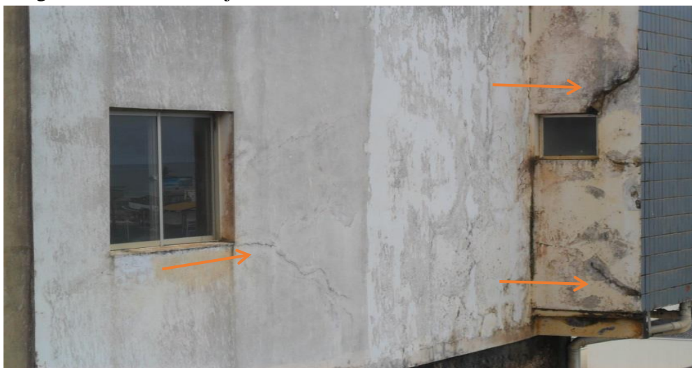
Figura 10 - Cantos das janelas com fissuras, fachada lateral do Edifício D.
