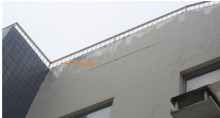
Figura 8 - Fissura horizontal da interface da platibanda com a cobertura, localizada na fachada lateral do Edifício A.
