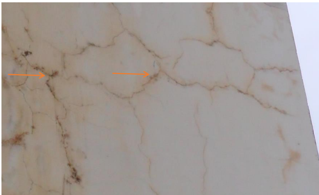
Figura 5 - Fissuras descontínuas em forma de mapas, localizadas no edifício D.
