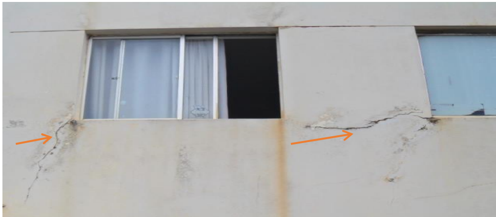
Figura 12 - Fissuras aparentes na parte inferior.
