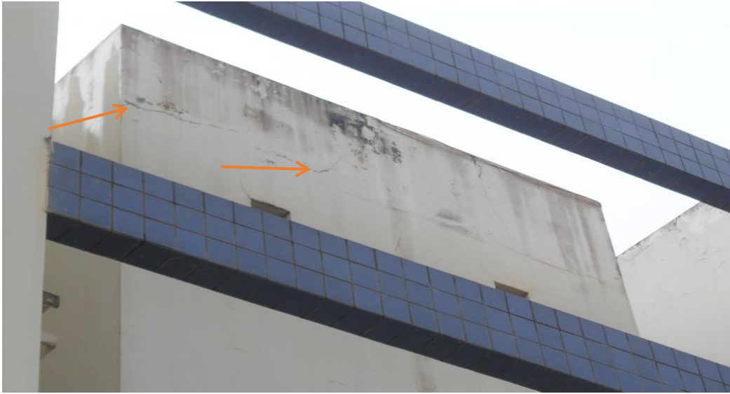
Figura 7 - Fissura na interface da platibanda com a laje de cobertura, localizada na fachada principal do Edifício A.
