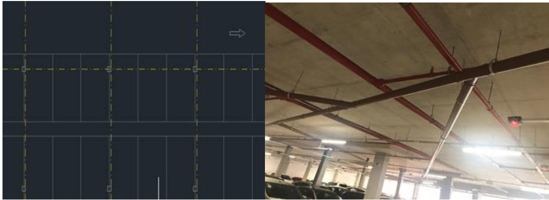
Imagem 1 – Tubulação de Água Pluvial Aparente
